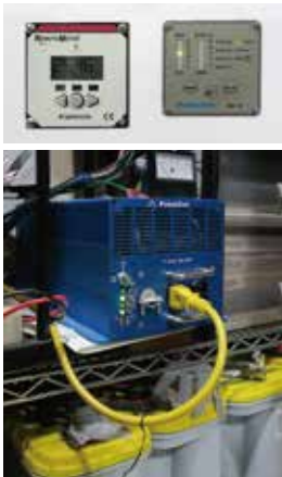
タナベスタジオ内で稼働している自家発電システム
